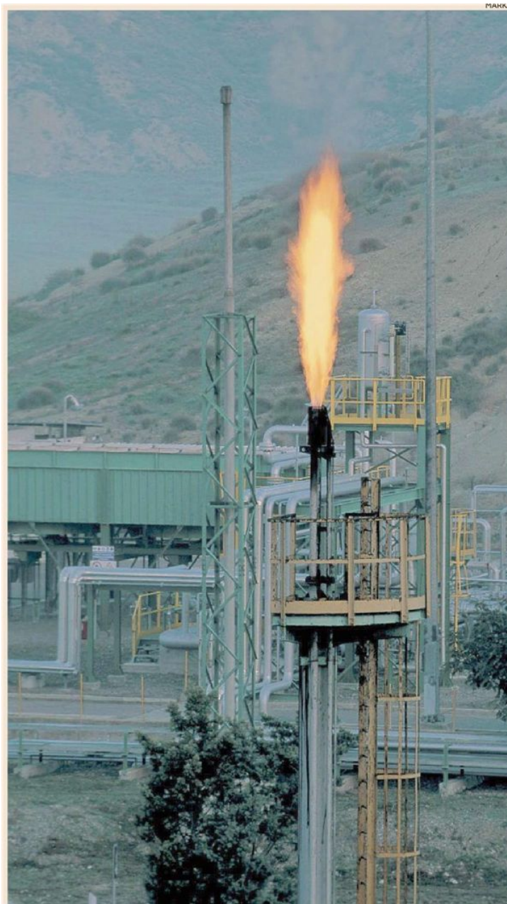
Un impianto in Val d'Agri. A Tempa Rossa la Total è impegnata a completare e testare le infrastrutture
