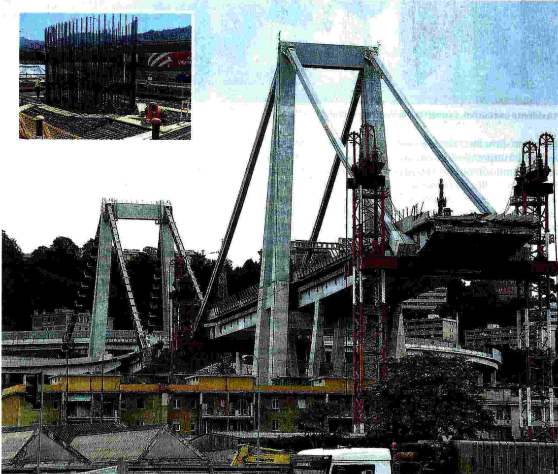
Pronto alla demolizione. Il Ponte pronto alla demolizione. Nel riquadro l'armatura del primo pilone della nuova struttura
