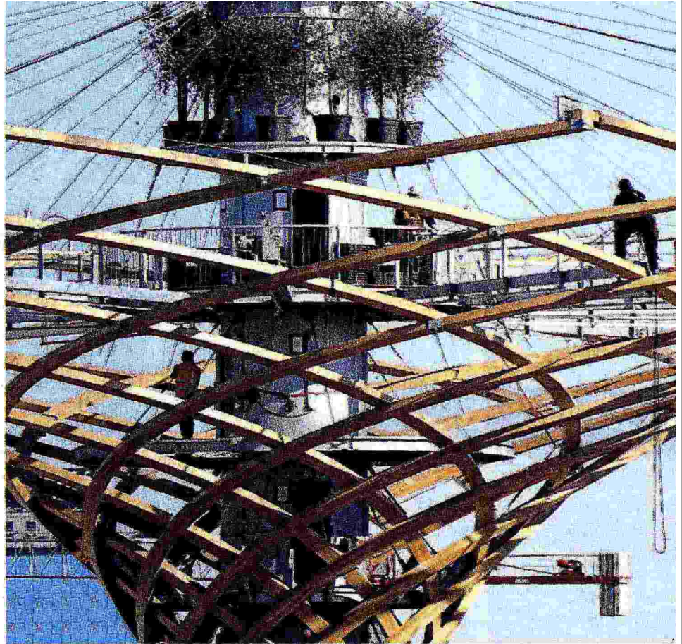
L'ALBERO DELLA VITA Continuano a ritmo frenetico i lavori all'Expo in vista dell'apertura. A destra, l'albero della vita
