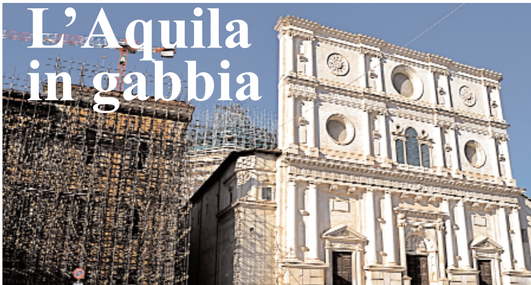
La Basilica di San Bernardino all'Aquila. E' uno dei tre cantieri di restauro avviati nel centro storico.
