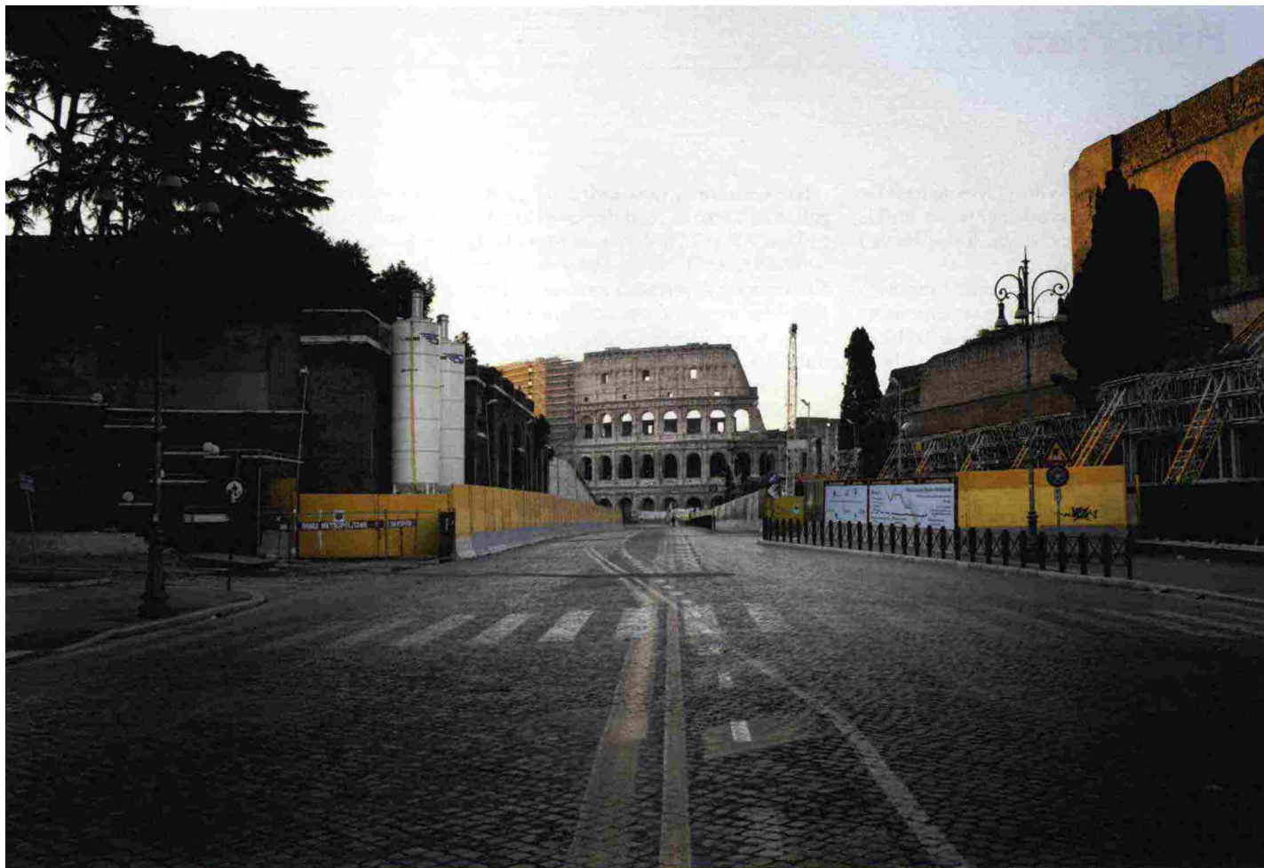
VIA DEI FORI IMPERIALI INVASA DAL CANTIERE PER LA NUOVA METRO C FRA IMPALCATURE CHE REGGONO I MONUMENTI E SCAVI PER LA NUOVA STAZIONE
