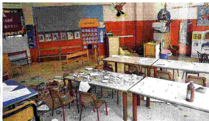
Calcinacci L'aula della scuola materna «Vittorino da Feltre» di Sesto San Giovanni: l'intonaco del soffitto è crollato su sette bambini (Fotografia)
