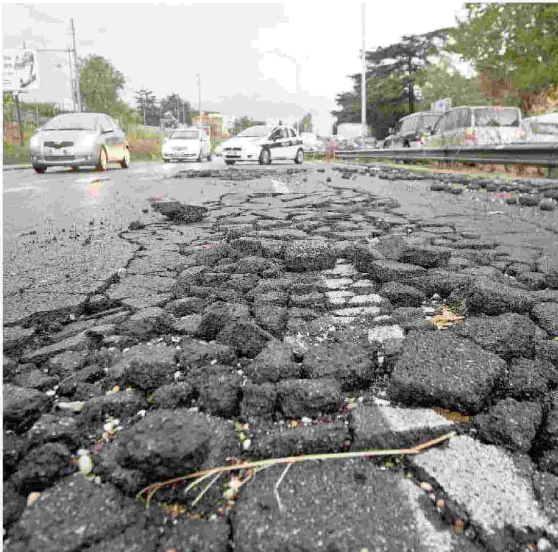
Le buche nell'asfalto causate dalla pioggia torrenziale sulla Salaria
